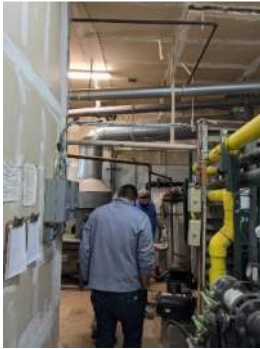
Pool Equip Room
